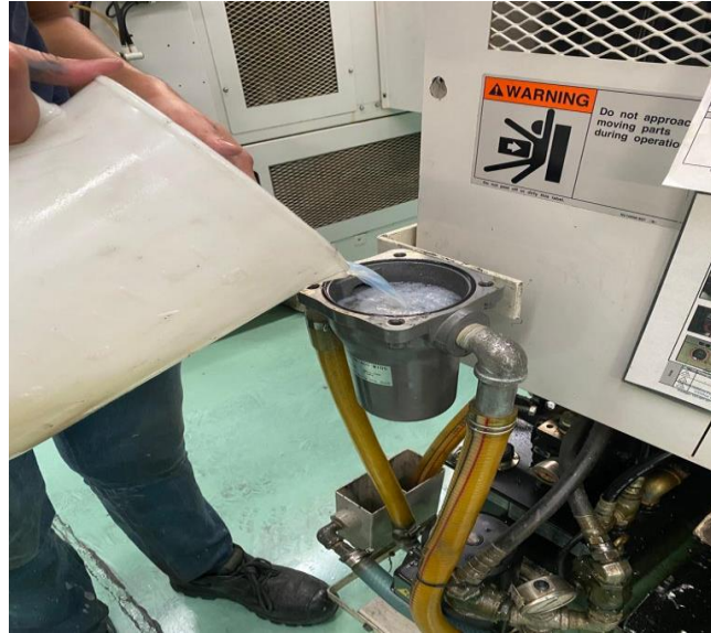
Imagen 25. Purgación de bomba
